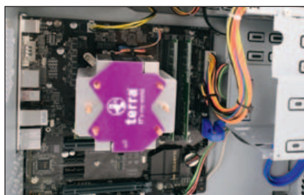
Der Wortmann Terra ist sehr gut verarbeitet. Die Kabel im Inneren des PCs sind sauber verlegt.
